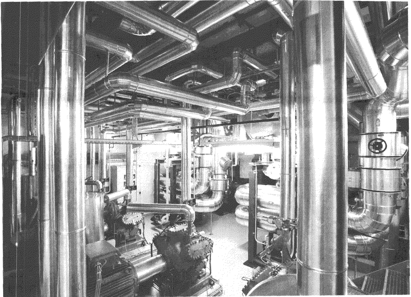
Wärmepumpen heizen das Wasser in der Energiezentrale Rietbach auf maximal 80 Grad Celsius auf. Foto: Tom Kawara
