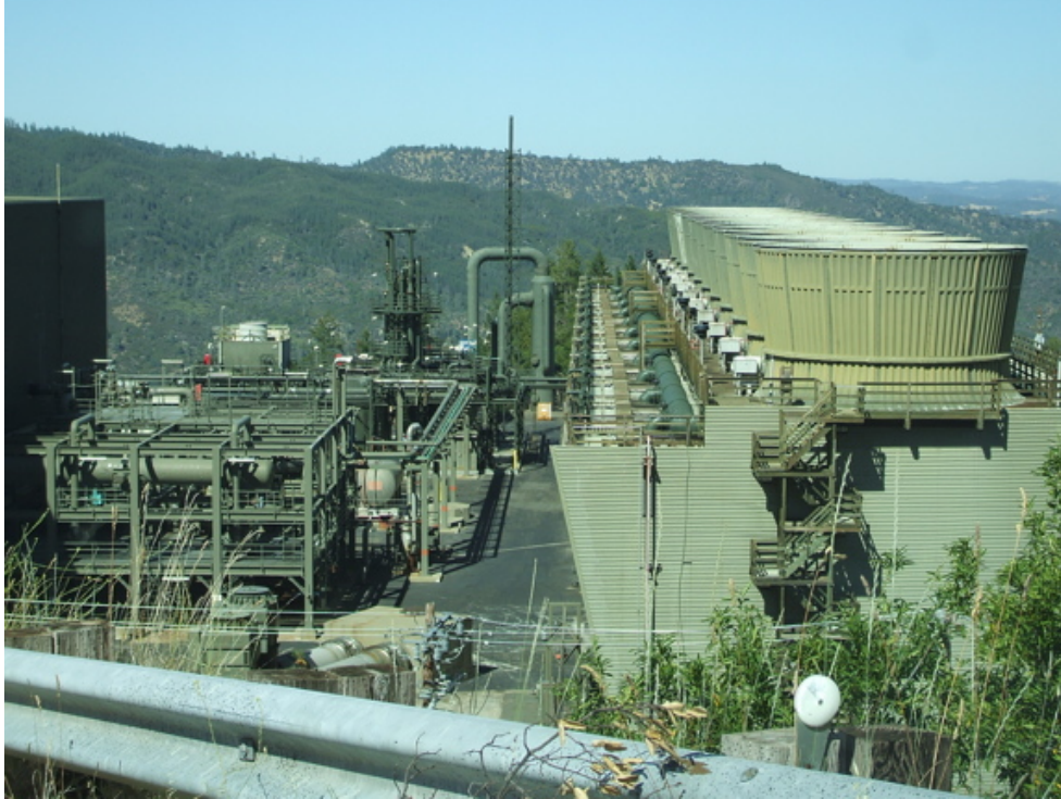
Figur 21: Beispiel eines geothermischen Kraftwerks mit Verdunstungskühlung. The Geysers, Kalifornien (Foto: M. Häring)
