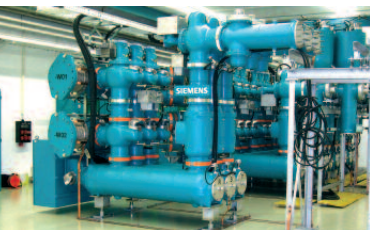
Moderne 150-kV-SF6-Schaltanlage wie sie im Unterwerk Sempersteig bereits eingebaut ist.
