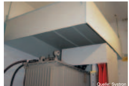
Bild 4 MS/NS-Transformator mit Trafo- und Anschluss-Abschirmhaube, eingebaut an der TS Schaffhauserstrasse
