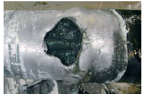
Frühzeitig entdeckter hochohmiger Fehler in einer alten Kabelmuffe.
