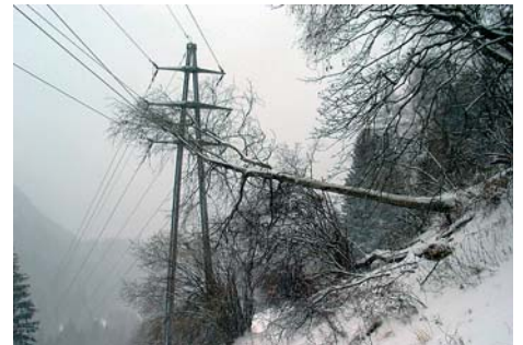
Unterbruch der 60-kV-Übertragungsleitung zwischen Unterwerk Sand und Unterwerk Dieschen.
