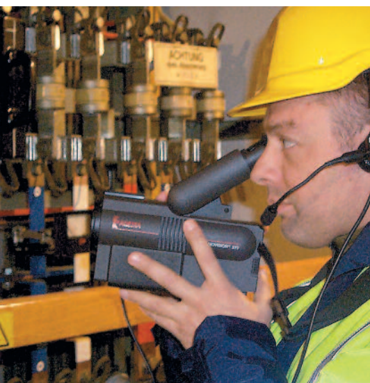
Thermografie von Anlagenkomponenten.
