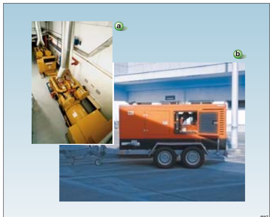
Bild 3 Notstrom-Dieselaggregate können fest installiert oder mobil sein
