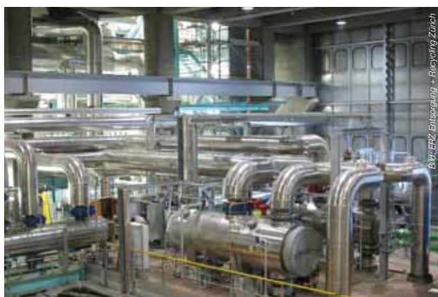
Speisen heisses Wasser in die Fernwärmenetze ein: Heizkondensatoren im neuen Holzheizkraftwerk Aubrugg.
