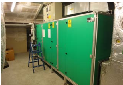
Lüftungsanlage im Dachgeschoss
