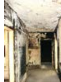
Entrée WH Magnusstrasse
