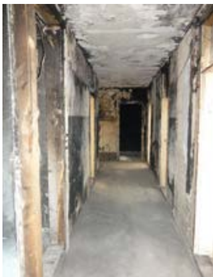
Dachgeschoss mit Brandschäden
