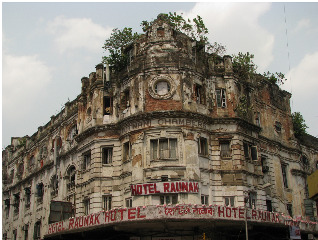
Abbildung 2: Durch Witterungseinflüsse und biologischen Bewuchs stark gealtertes Gebäude (Foto: Savage McKay, flickr)
