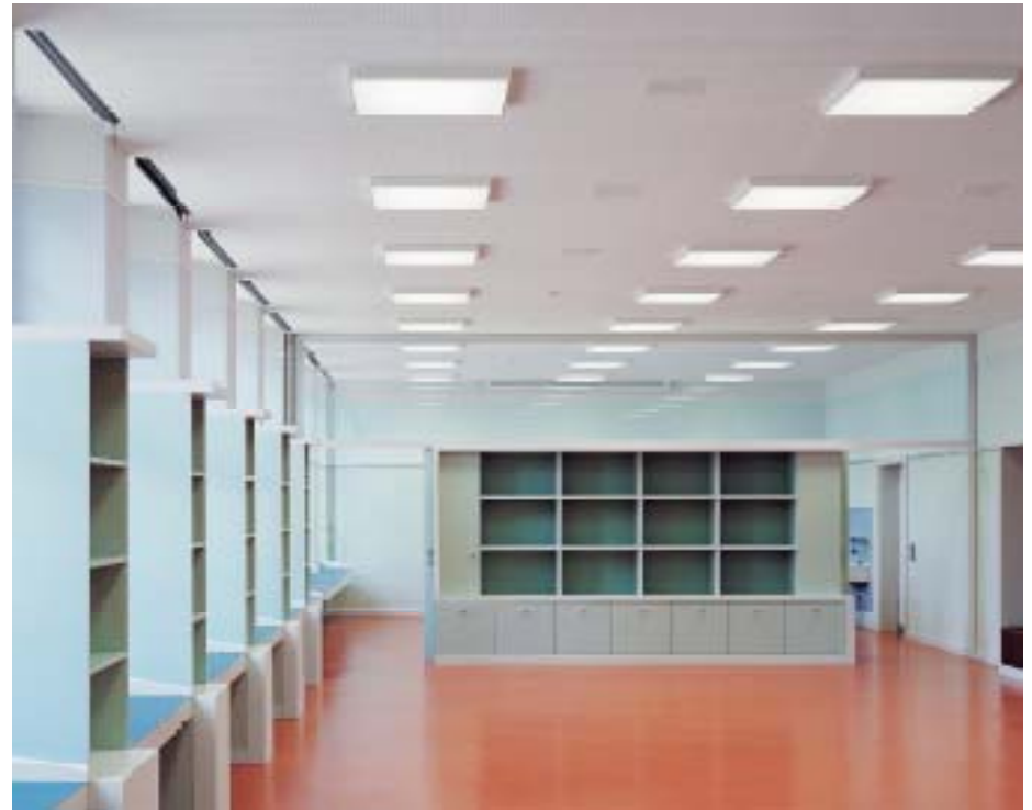
Instandsetzung und Umbau Schulanlage Milchbuck. Anforderung MINERGIE-Beleuchtung erreicht, MINERGIE-Modul Leuchten eingesetzt.
