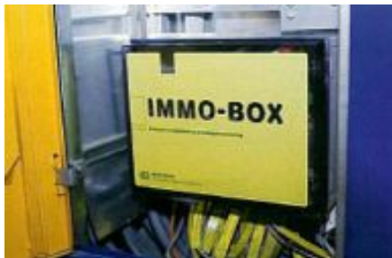
Abbildung 22: IMMO-Box zur Erfassung der Energie- und Medienverbräuche
