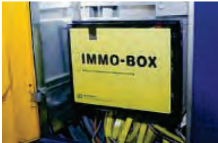
Abbildung 24: IMMO-Box zur Erfassung der Energie- und Medienverbräuche
