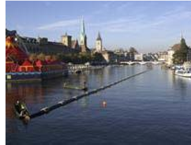
EV Fraumünster, Seewasserleitung vor der Verankerung auf dem Grund
