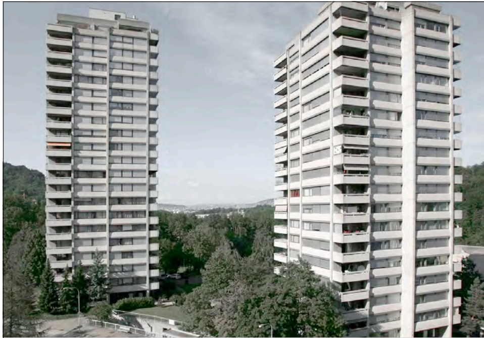
Massivbauweise in Beton mit Innendämmung, offene Balkone nur begrenzt nutzbar, Betonschäden... Hochhausanierung Sihlweid in Zürich-Leimbach der BGZ, Architekten Harder Haas Partner AG, 8193 Eglisau
