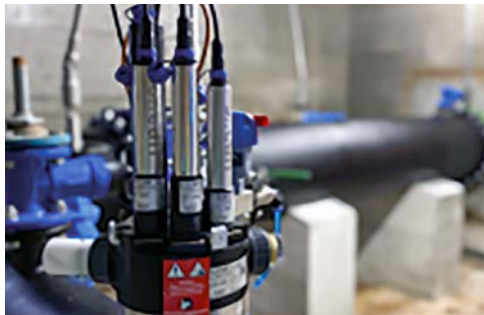
Online Mess-Sonde, Schachteinbau (Bild: Wasserversorgung Zürich)
