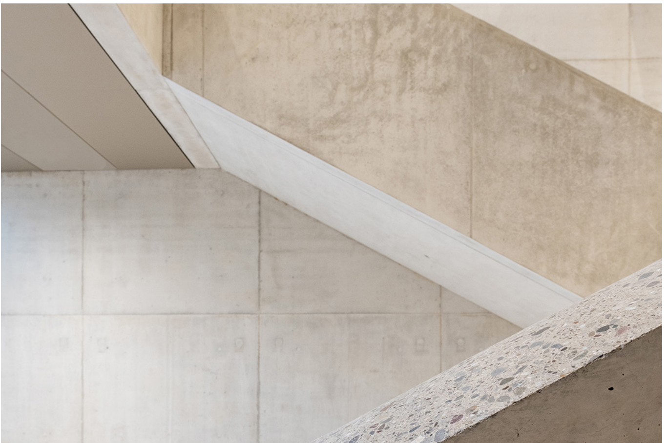
Für den konsequenten Einsatz von Recycling-Beton hat die Stadt den «Procura+ Award» erhalten (Bild: Juliet Haller, Zürich).
