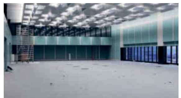
Der grösste Raum steht bereit für den Umzug der Einsatzleitzentrale. Die Möbel sind mittlerweile ausgeliefert.
