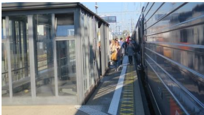
Defizit ⑤: Zu schmales Perron zwischen Wartehäuschen und Gleis bestehend.
