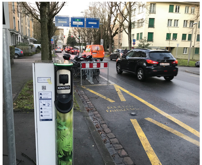
Der Ausbau der Ladeinfrastruktur (Bild: Ladestation in Basel) ist eine wichtige Voraussetzung für den weiteren Ausbau der Elektromobilität. Foto: B. Vogel
