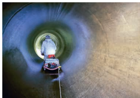
Hangzonen-Leitung DN 1350 mm: Inneninspektion und Korrosionsuntersuchung im Abschnitt Sonnenbergstrasse. (Bild: WVZ)
