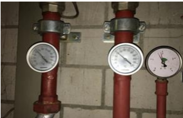
Vorlauftemperatur bei ca. -1°C
