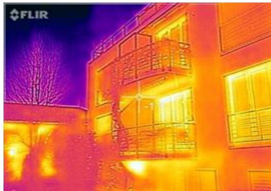
Thermisch getrennte Balkone auf Infrarotaufnahme
