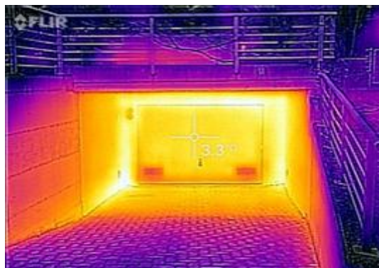
hohe Temperatur beim Einlegen (vermutlich schlecht gedämmte Garagendecke?)
