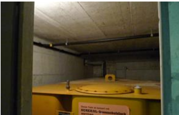
oben: Tankraumdecke mit wenig Dämmung über Beton
