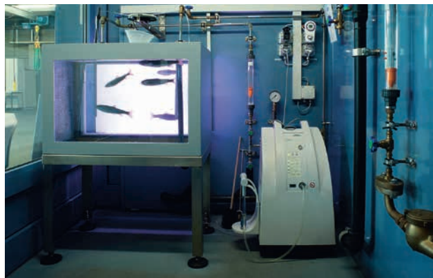
Forellen reagieren empfindlich auf fremdartige Stoffe. In der Fischtestanlage im Seewasserwerk Lengg werden sie daher zusätzlich zur Kontrolle eingesetzt.
