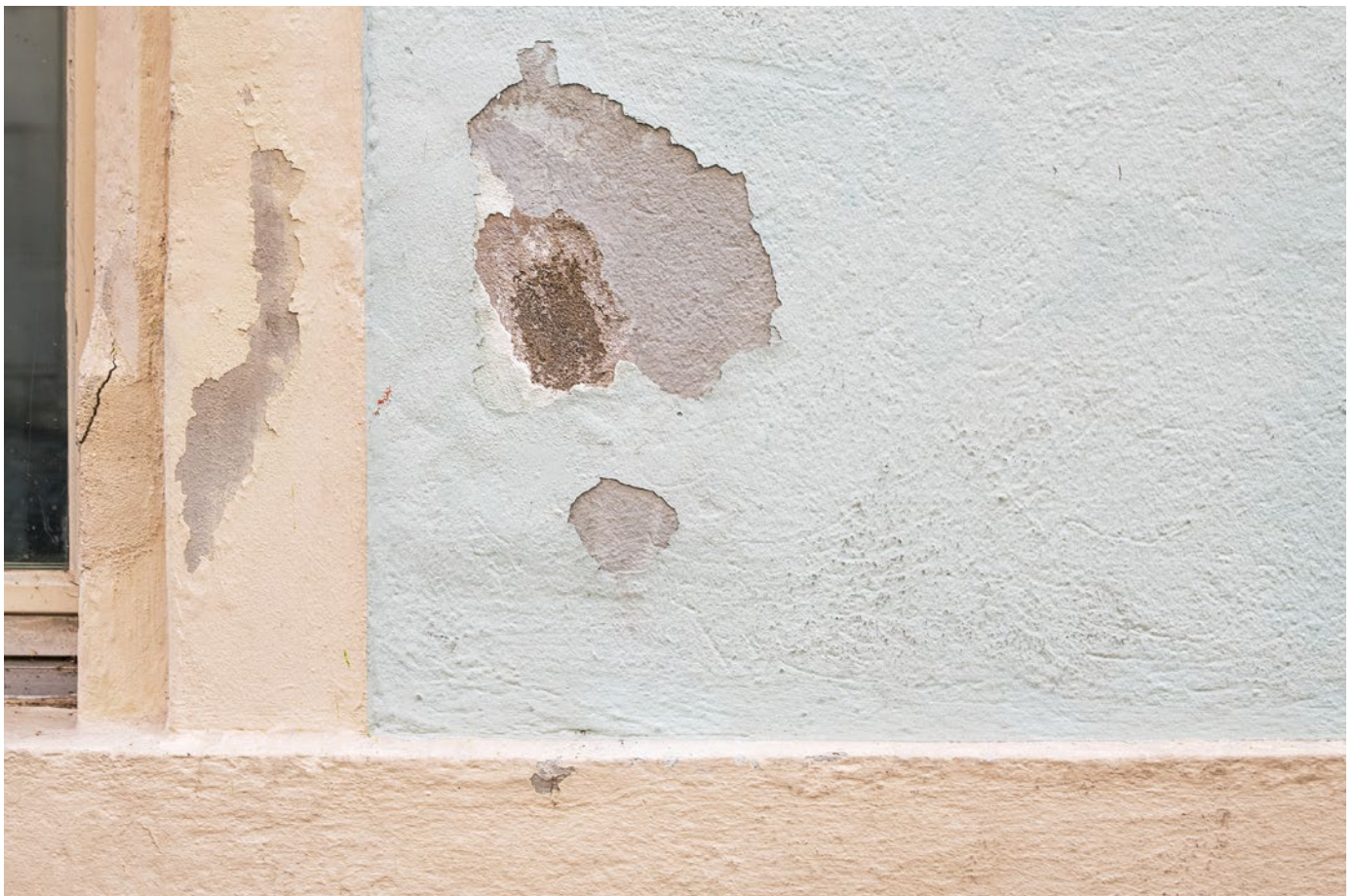
Schadstelle mit sichtbar darunterliegenden älteren Farb- und Putzschichten
