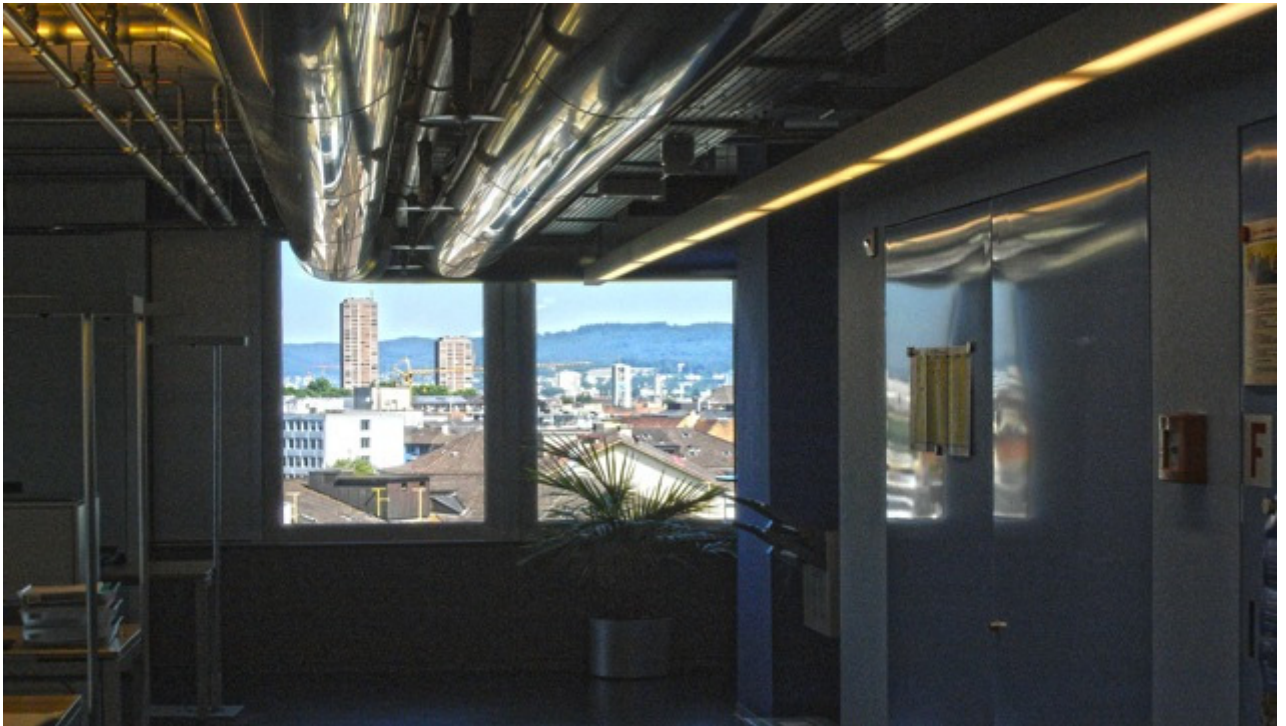
Abbildung 6: Korridor im 8. OG mit der bisherigen Leuchtstofflampen-Beleuchtung
