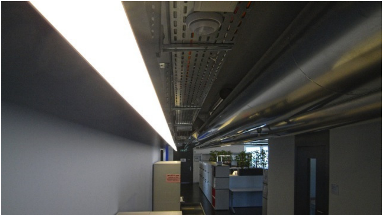
Abbildung 4: Korridor im 7. OG mit neuer LED-Lichtschiene
