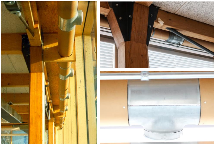
Abbildung 12: Detailaufnahmen zur Kartonlüftungsanlage im XX Office in Delft (Architektur: Jouke Post).
