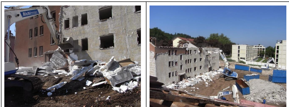
Abbildung 10: Abtrennung der gesamten Kompaktfassade vom Mauerwerk auf einer Baustelle in der Stadt Zürich.
