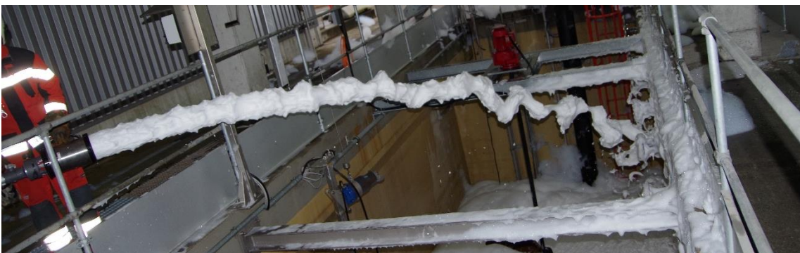
Bild 16: Schaumabgabe bei 3,4 bar am M2 Rohr (Quelle: Holger de Vries)
