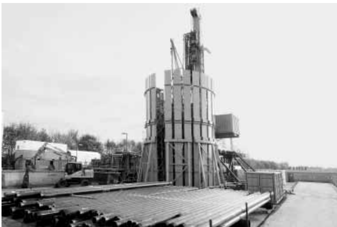
3 Geothermie, Erhöhung Objektkredit auf 38,7 Mio. Franken | Seiten 11–13
