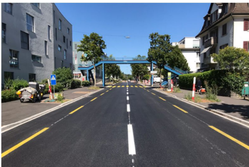
Regensbergstrasse: Nach Abschluss der Sanierungsarbeiten an der Regensbergstrasse wurde auf beiden Seiten ein rund 600 m langer Velostreifen markiert.
