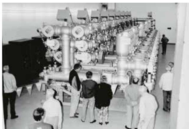
Tag der offenen Tür im Unterwerk Altstetten (150-kV-Schaltanlage SF6-gasisoliert), 26. Juni 1993. In der damaligen Legende dazu steht: «Für manche Laien eher das Raumschiff Enterprise als die SF6-Schaltanlage.» (Quelle: Stadtarchiv Zürich)
