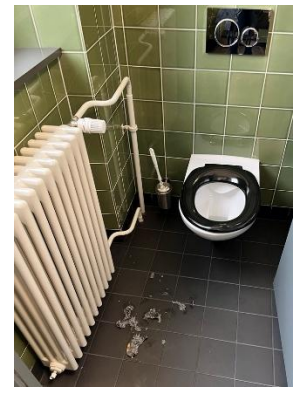
Übermässig verschmutzte WC
