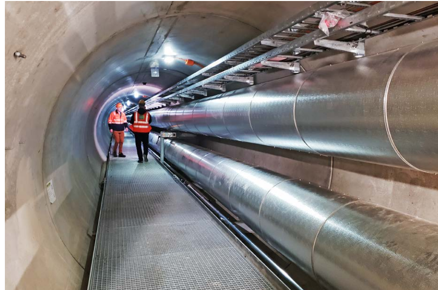
Das für Zürich-West benötigte Heisswasser fliesst durch Rohrleitungen mit einem Durchmesser von 50 cm.
