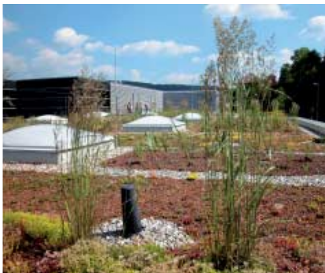
Kombinationen von intensiven und extensiven Dachbegrünungen fördern die Vielfalt und den Erlebniswert von Dachbegrünungen. (Bild Bauder AG)
