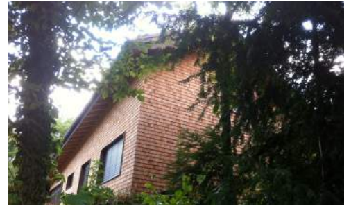
Fassade aus Eibenschindeln. Foto: P. Schmider
