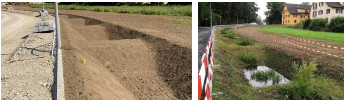
Abbildung 3: Umsetzung Kaskadenmulden Fronwaldstrasse, Zürich (Fotos: TAZ)
