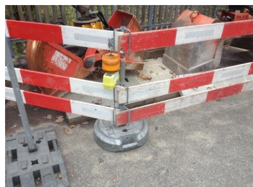
Mögliche Lösung: Dritte Lattenreihe, dafür ist aber keine gültige Norm vorhanden
