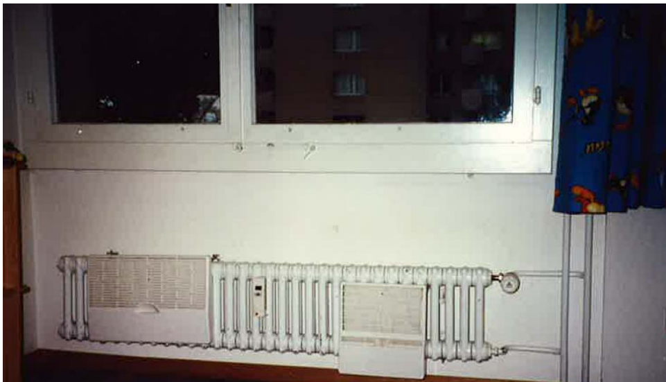
Figur 37 Wohnsiedlung Paradies, Bestehender Gliederheizkörper
