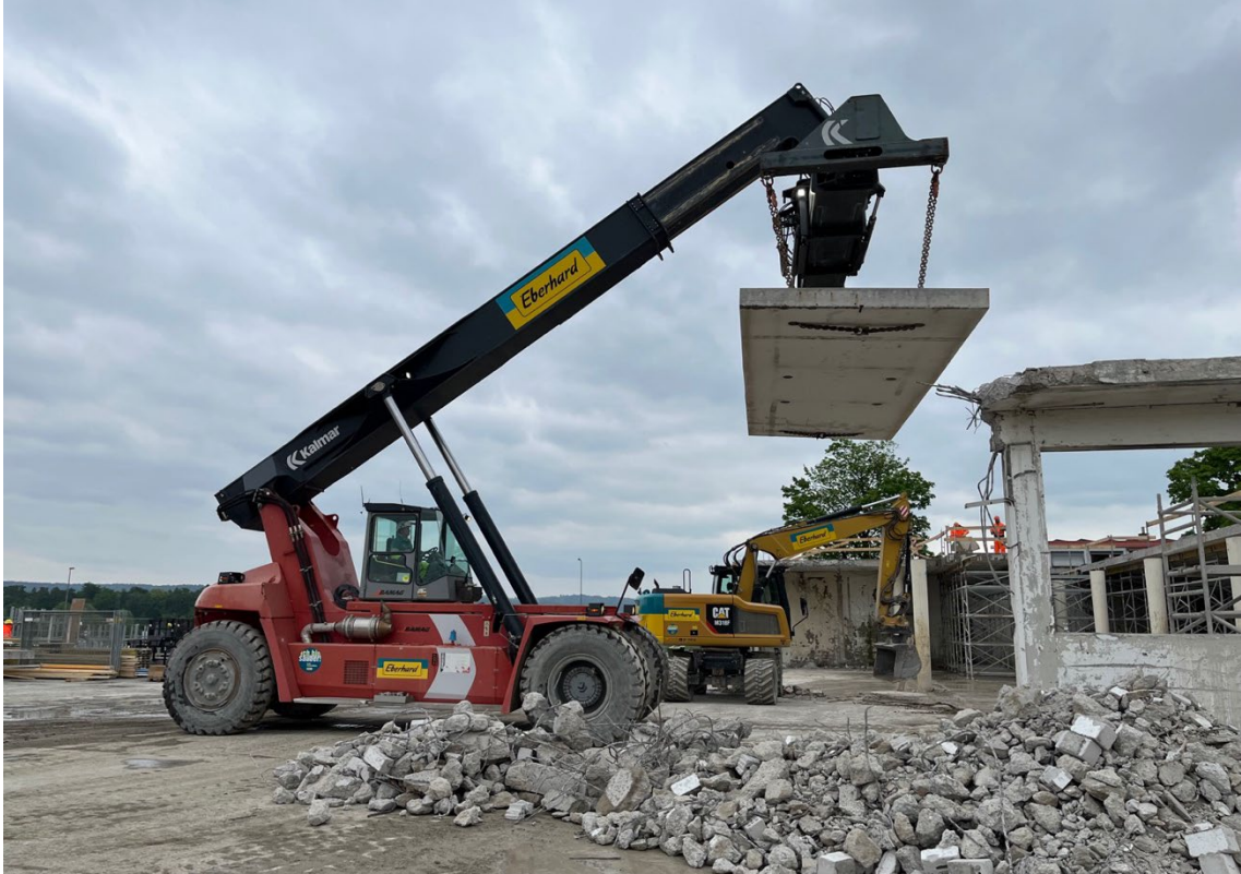
Abb.49 Das Deckenelement wird über vier Löcher und zwei Ketten an den Greifstapler angehängen (© ZHAW IKE, 07.05.2025,)
