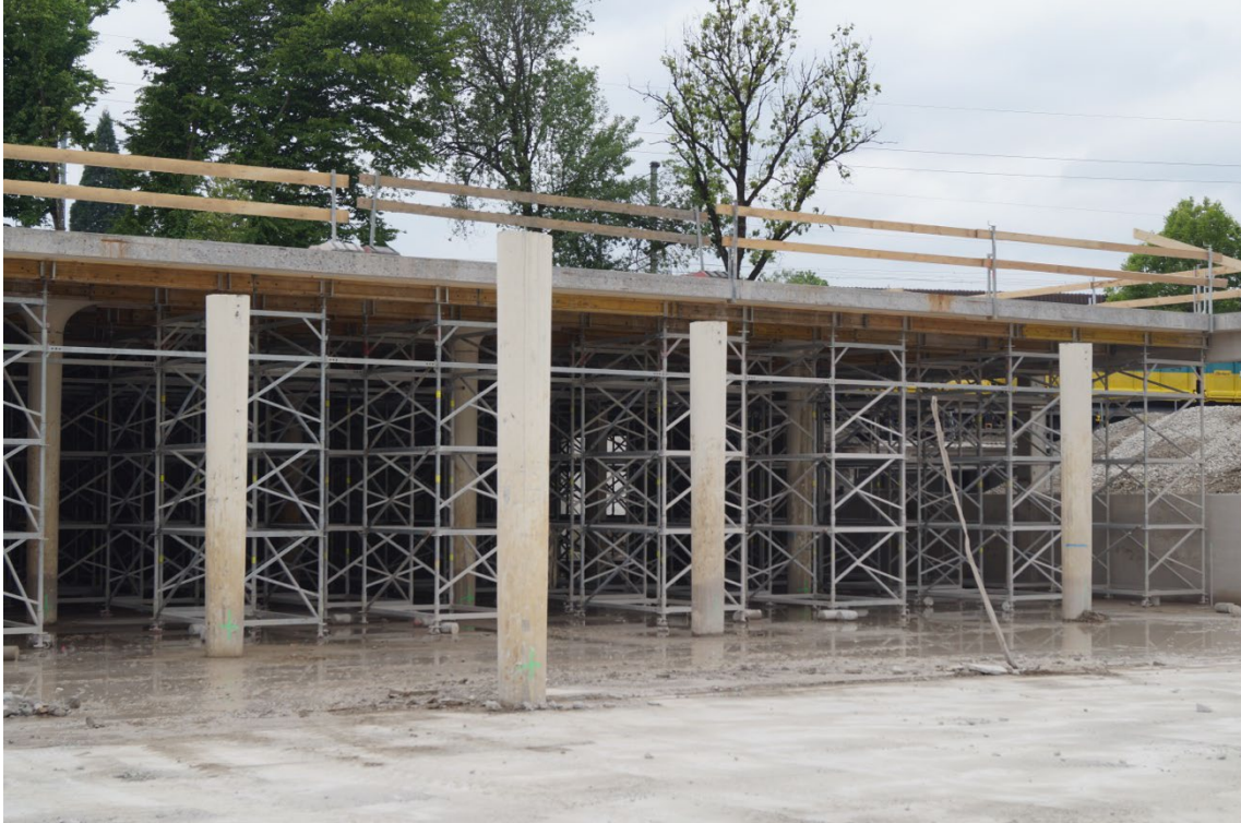
Abb. 47 Die stehenden Stützen nach dem Ernten der Deckenelemente inkl. Pilzköpfe (© ZHAW IKE, 07.05.2025)
