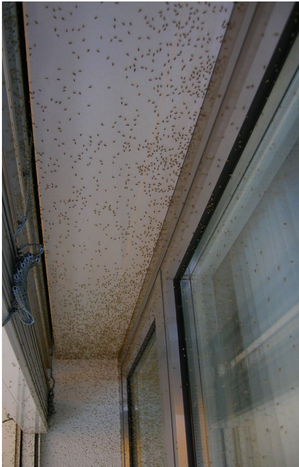
Massives Auftreten von Halmfliegen auf einem Balkon der obersten Etage. Mit Fliegengittern könnte man den Raum lüften, ohne die Tiere in Innenräumen zu haben. Foto: Stadt Zürich, UGZ
