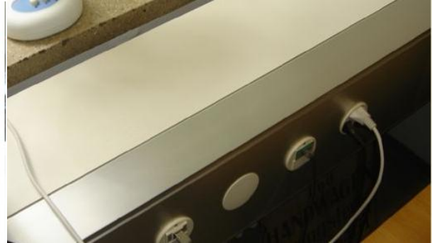
Kabelkanal am Fenstersims
