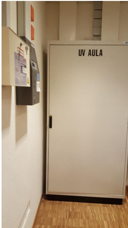
Abbildung 11: Separater Technikraum mit Ansicht auf Elektroverteilung und Notlichtzentrale 24V DC.
