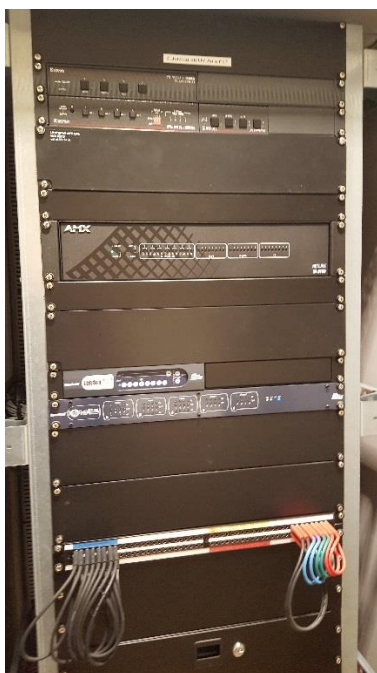
Abbildung 13: Rack Bühnentechnik mit Verstärker der Hörlosenschleife
