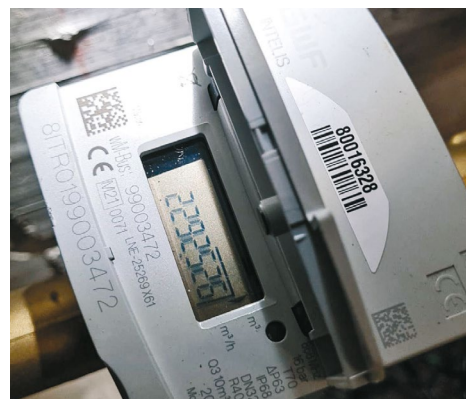
Smart Meter: Neue, digitale Zähler unter anderem zur effiziente Übermittlung von Verbrauchsdaten
