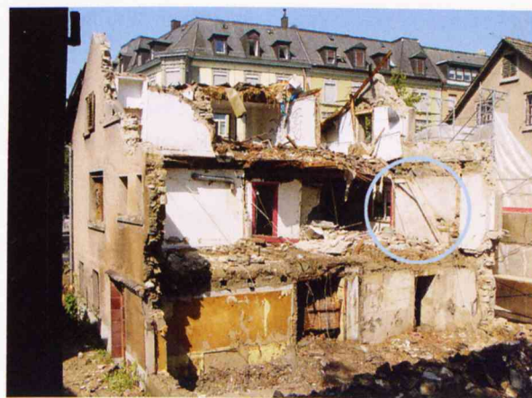
Kreuzplatz 3/4. Erst beim Abbruch sichtbar geworden: Der Dachstuhl des ersten, um 1830 erstellten Gebäudes. Er wurde bei der Gebäudevergrößerung einfach an Ort und Stelle belassen (blauer Kreis). (Foto Stadtarchäologie, 2002)
